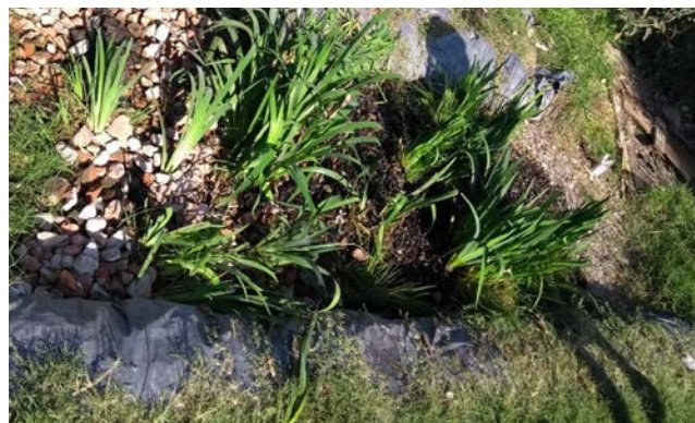
Imagen 5. Humedal terminado con totoras plantadas.
