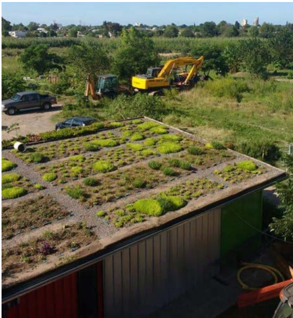
Figura 6. Cubierta verde en funcionamiento.
